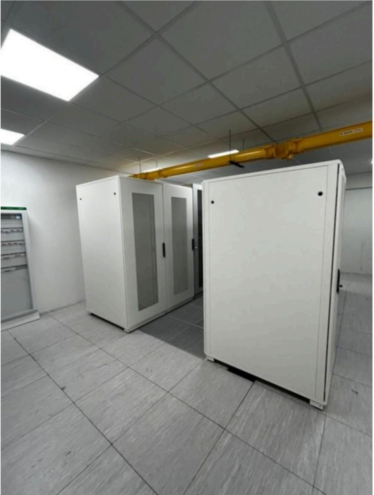
I rack di FBK (bianchi) nel data center di Trentino Digitale
