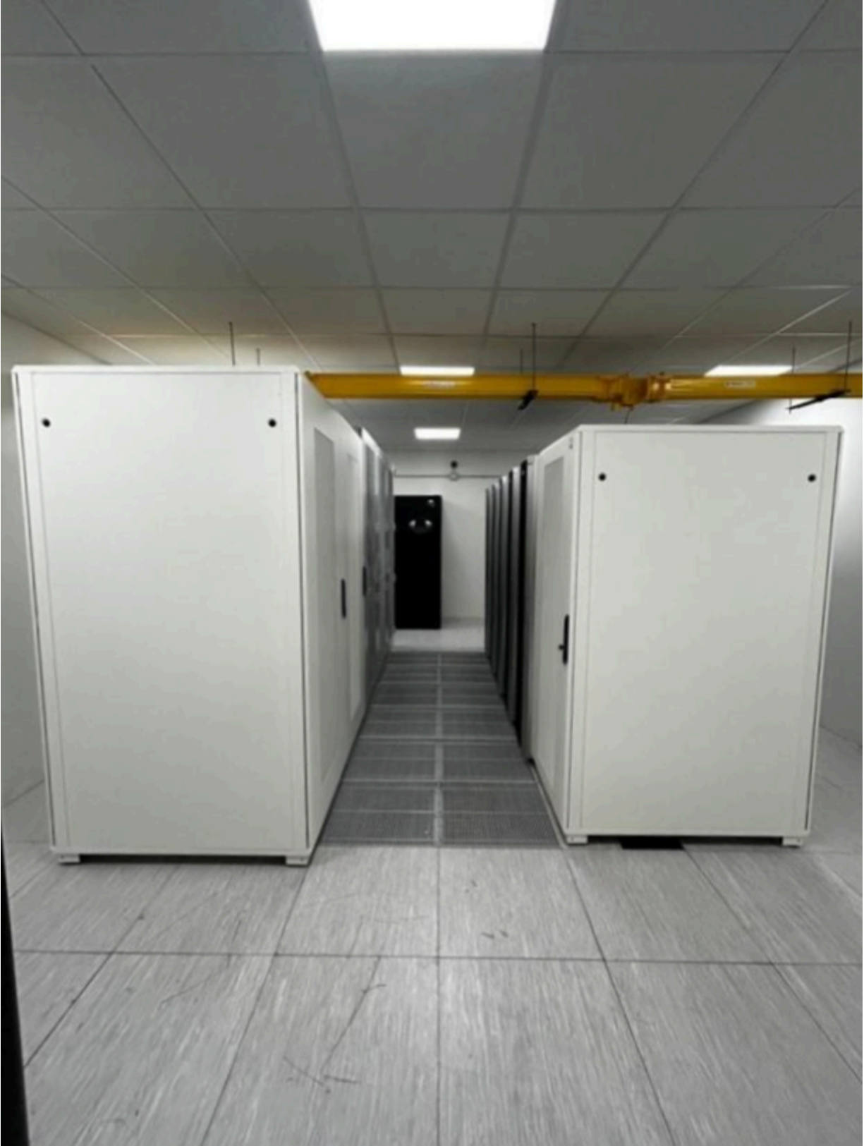
La sala server di Trentino Digitale
