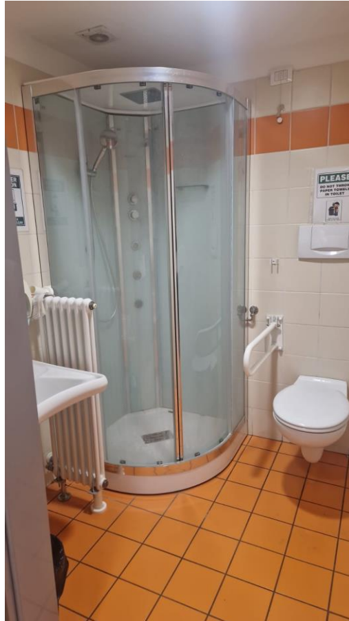
Figura 6 doccia a libero uso dei dipendenti e delle collocate presso via alla Cascata 56
